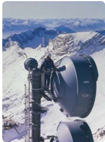
Impianto di telecomunicazione in alta quota con scala di alluminio (cima Zugspitze)
