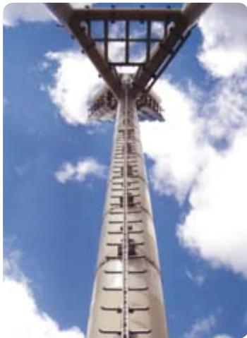
Pilone di illuminazione per l'illuminazione dello stadio con scala in acciaio galvanizzato
